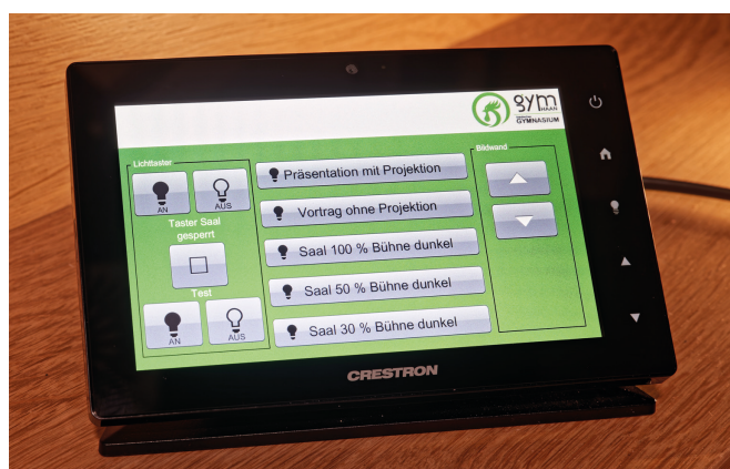
Crestron Touchpanel für eine einfache und intuitive Bedienung
